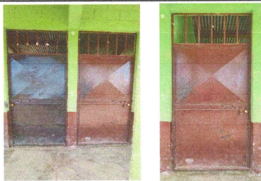
Foto 3: Se observa el deterioro de las puertas de metal.
